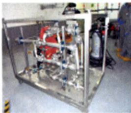
Equipo de Distribución de Lodos
