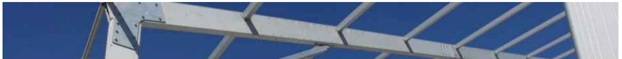
Figura 2.- Estado de las estructuras de apoyo de la cubierta (izquierda de la Figura 1)
