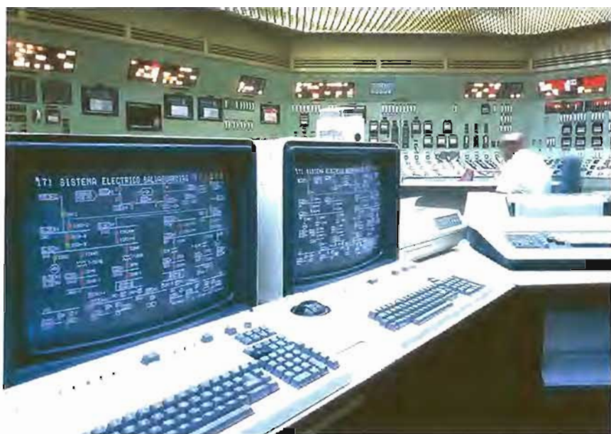
► Figura 3. La redundancia de instalaciones exigidas por criterios de seguridad conduce a un aumento de los costes de inversión.
