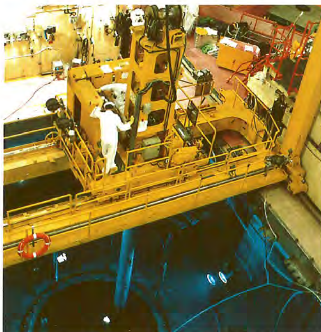
Vista parcial de la piscina del reactor de la central nuclear de Ascó.
