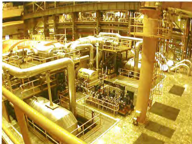
Vista general de la sala de turbinas de la central nuclear de Trillo.
