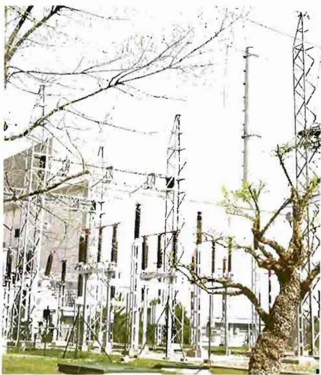
Vista parcial del parque eléctrico de la central nuclear Santa María de Garoña
