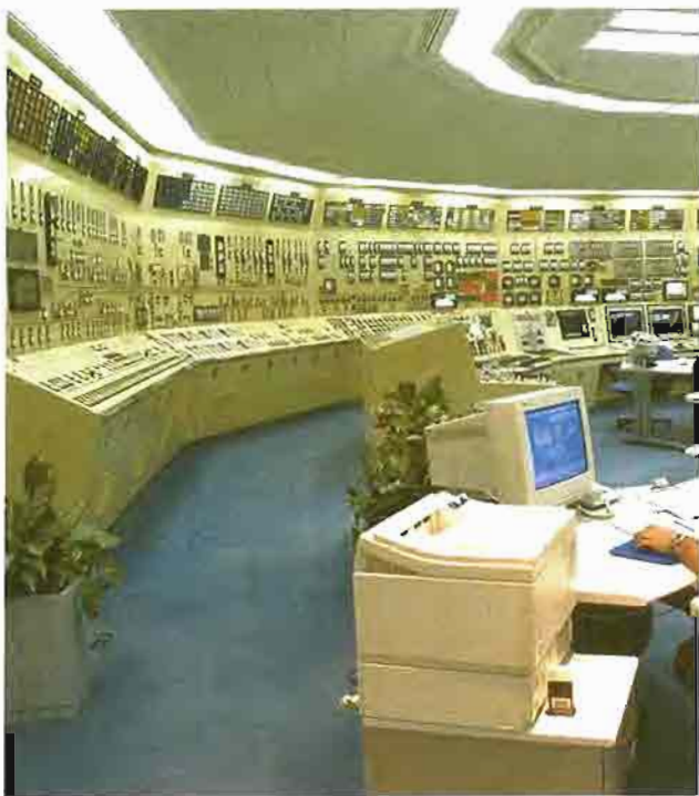
Sala de control de la central nuclear Vandellós II.
