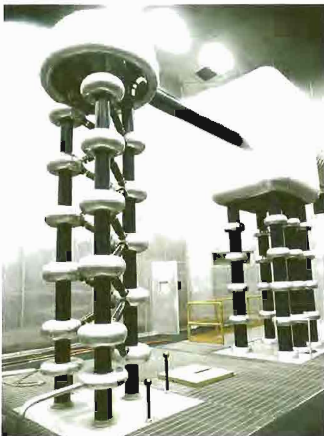
Figura 2. Generador eléctrico de tipo Cockcroft y Walton.
