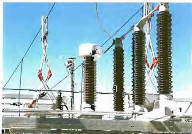
Detalle del parque eléctrico de la central nuclear de Cofrentes.
