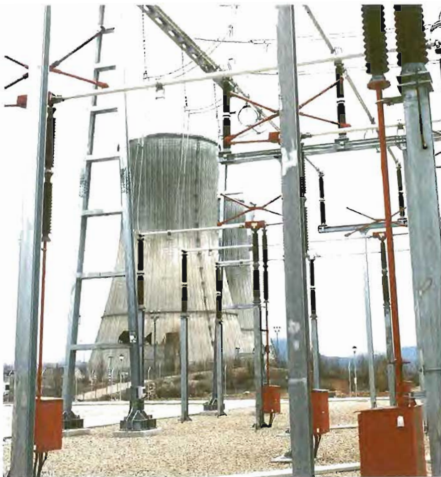
Figura 1. Vista parcial del parque eléctrico de la central nuclear de Trillo.
