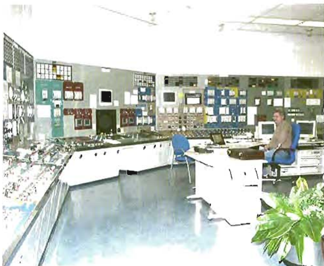
Sala de control de la central nuclear de Cofrentes.
