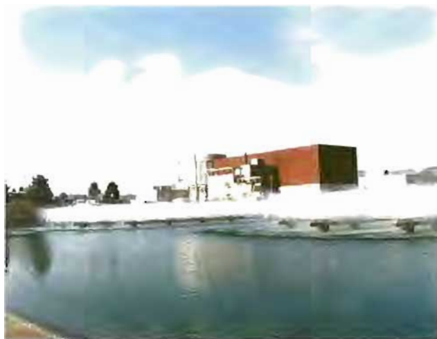
► Figura 8. Modificaciones de diseño asociadas al proyecto APE-110%. Operación de los aspersores del sumidero último de calor, con boquillas de nuevo diseño.
