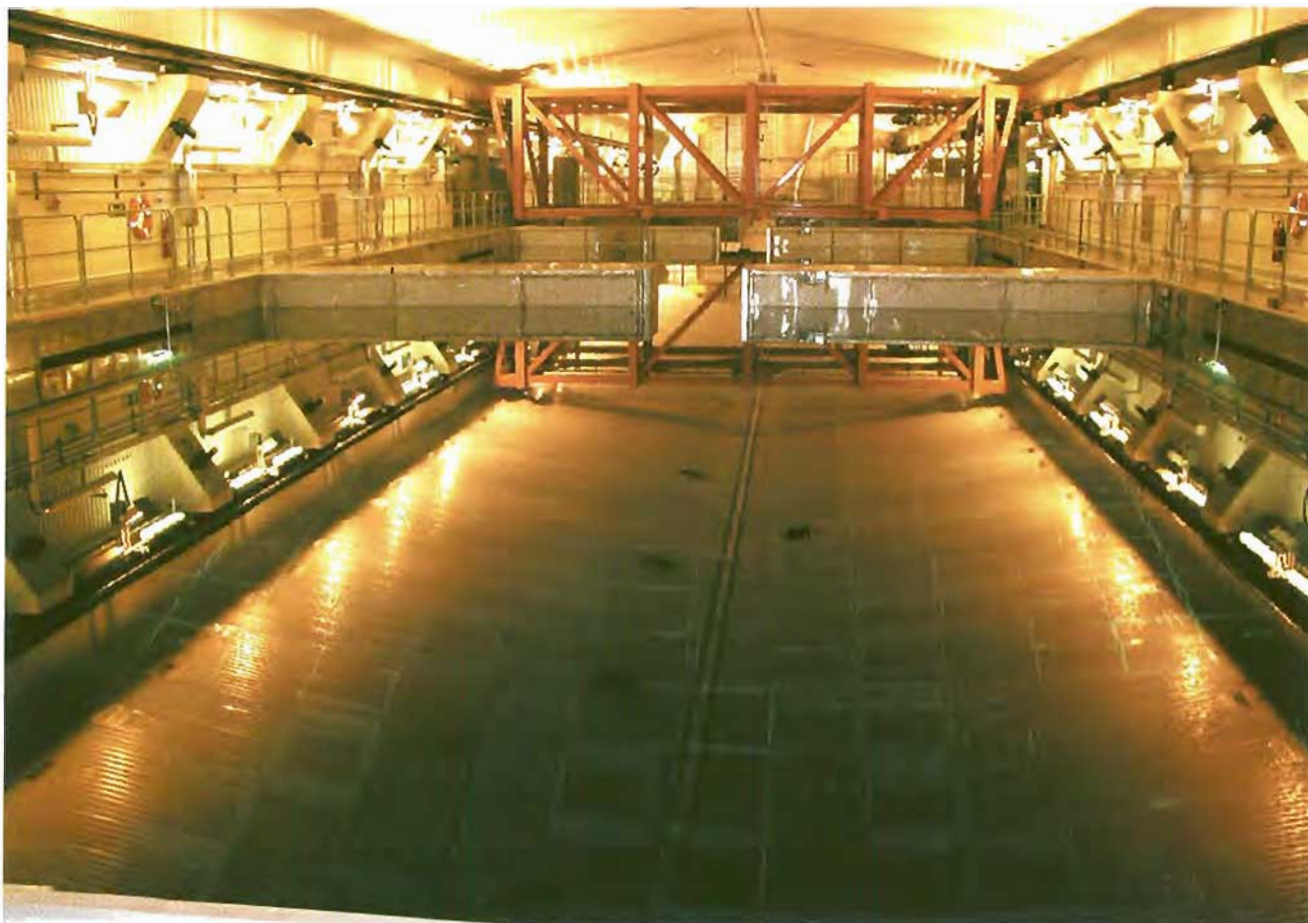
► Figura 3. Piscina de la instalación de almacenamiento Clab (Suecia).
