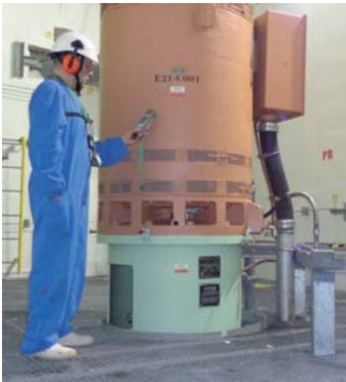
Control de las tasas de radiación en las proximidades del motor de la bomba del sistema de aspersión del núcleo a baja presión.
