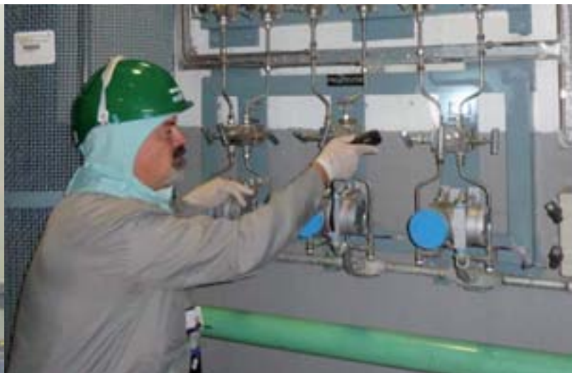
Supervisión del estado de la instrumentación local.
