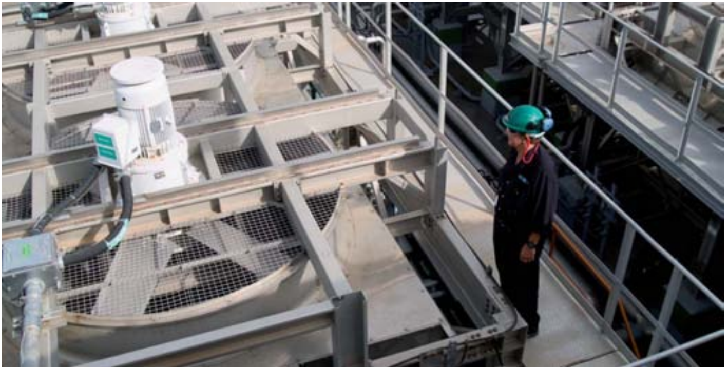
Comprobación del funcionamiento del ventilador de la torre de refrigeración de los generadores diesel de emergencia.
