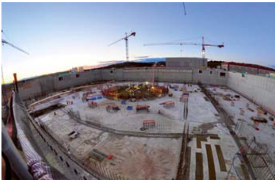
El 27 de agosto se terminó la plataforma donde se sienta el reactor.
