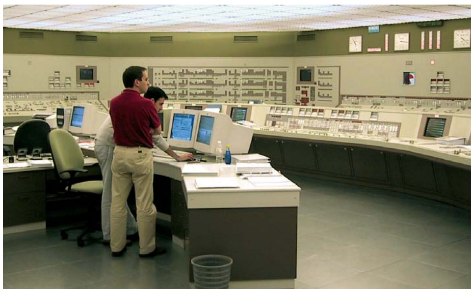
Simulador de la sala de control de la central nuclear de Trillo (Tecnatom).
