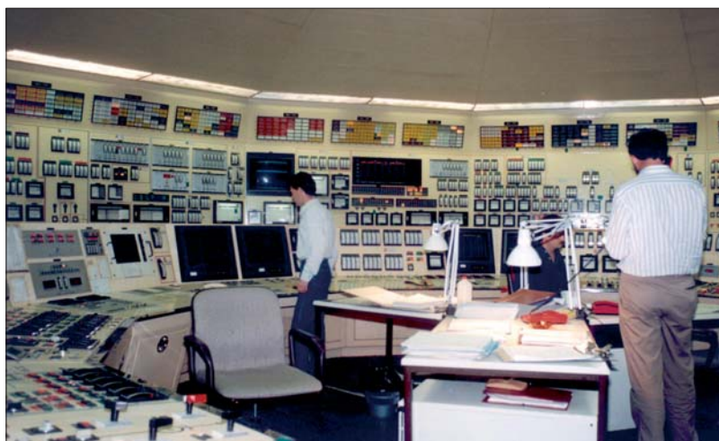
Sala de control de la central nuclear Vandellós II.
