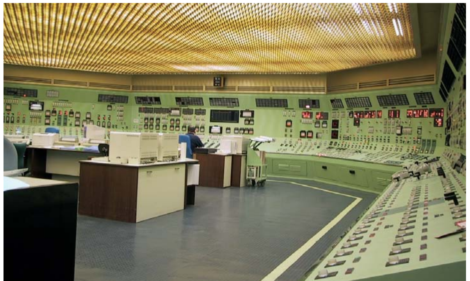
Simulador de la sala de control de la central nuclear de Almaraz (Tecnatom).
