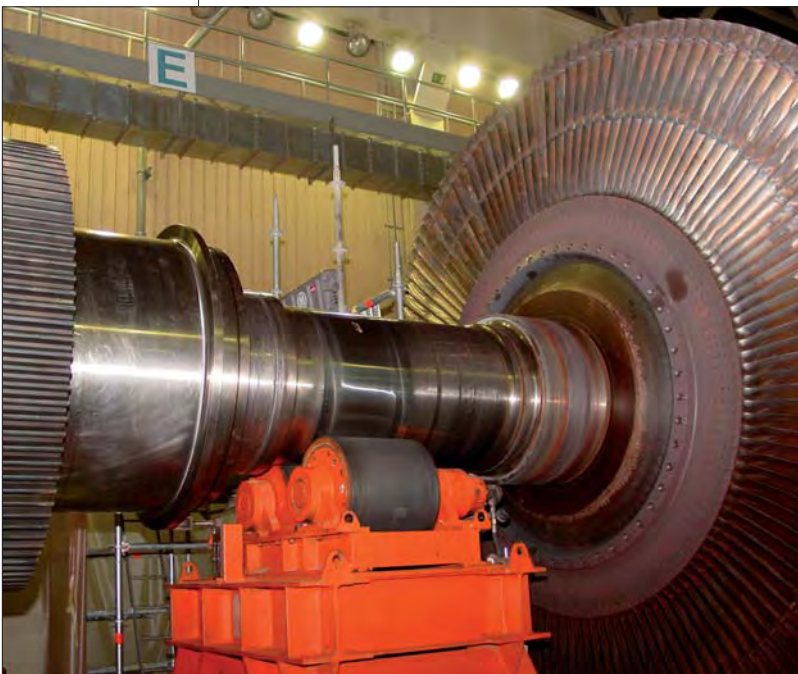
Rotor de turbina de la central nuclear de Cofrentes.
