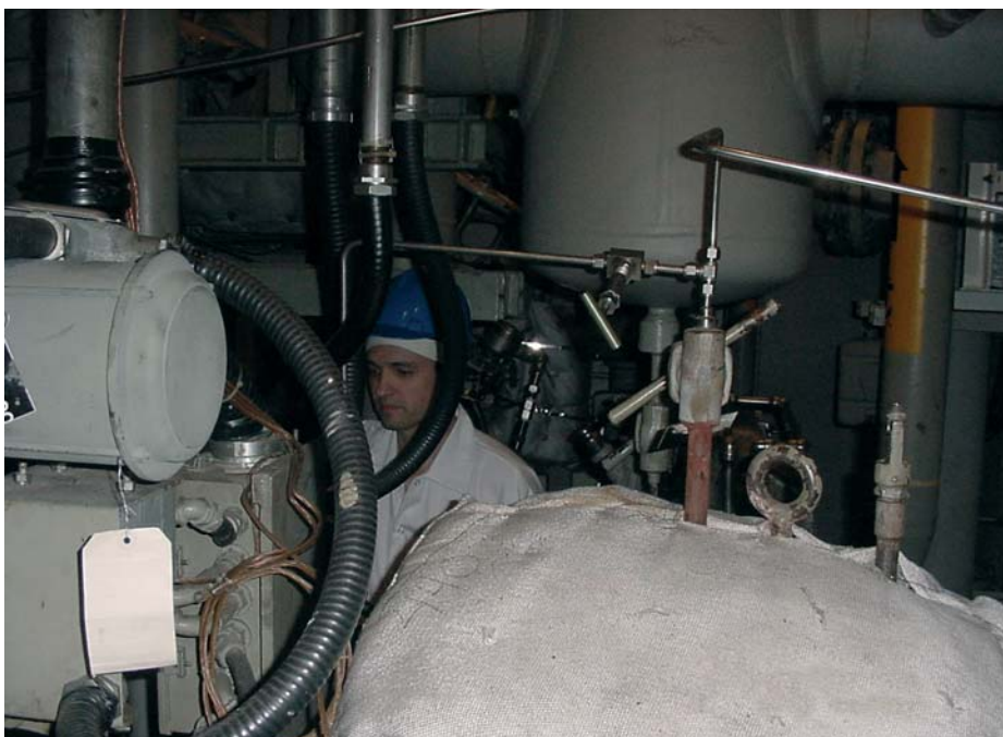
Sala de turbobomba de la central nuclear de Almaraz.
