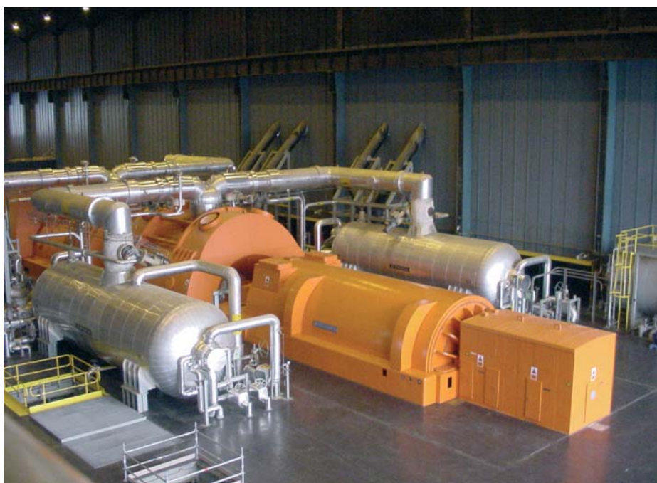
Turbina de la central nuclear de Almaraz.
